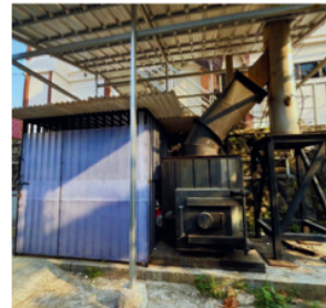
INSTALASI PENGENDALIAN PENCEMARAN UDARA
