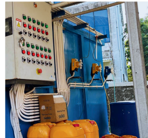
INSTALANSI PENGOLAHAN AIR LIMBAH
